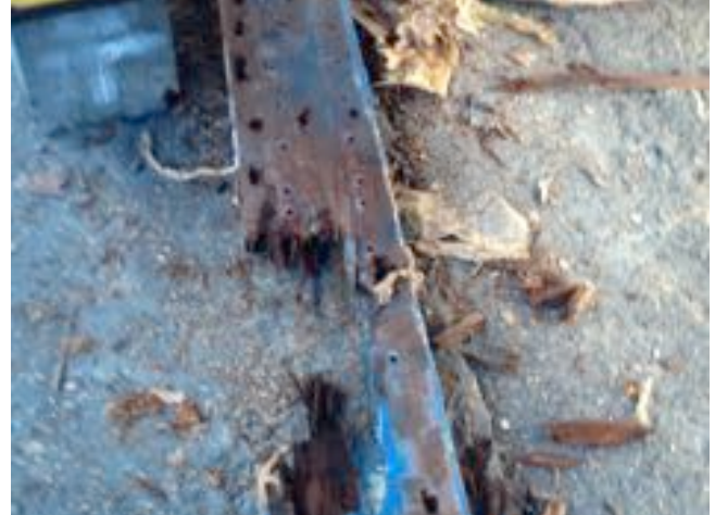
Le bordé déposé laisse apparaître une partie de bois mou.
