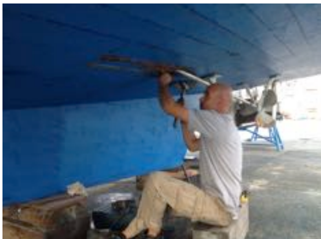
Javier Rendo, le charpentier, démonte les plaques en bronze pour les donner à refaire à neuf par le ferronnier du chantier.
